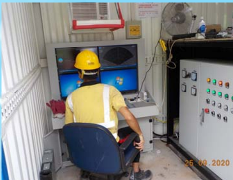
機械人控制台 Control panel of desilting robot
